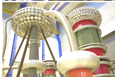
Em cima: receção do novo transformador de testes de 800 kV para o Laboratório AT.
